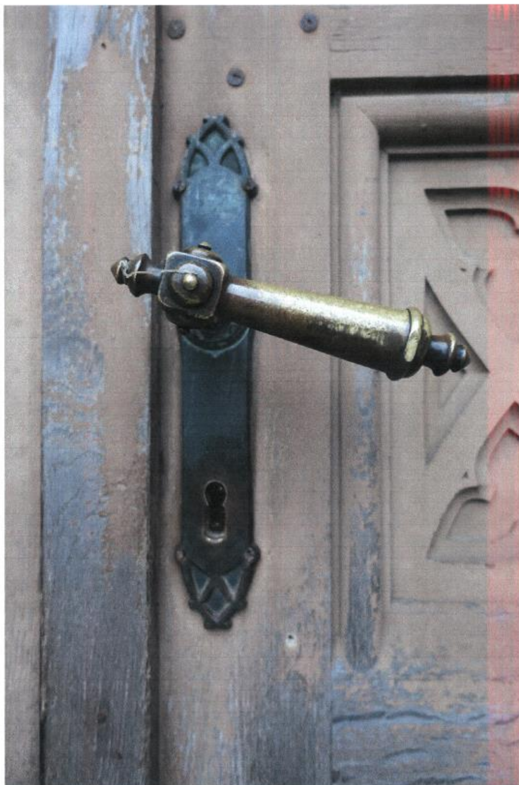
Fot.5. Kościół pw. Przemienienia Pańskiego, Sońsk, drzwi główne, od zewnątrz, zniszczenia powierzchni, fot. R. Gazda'2024
