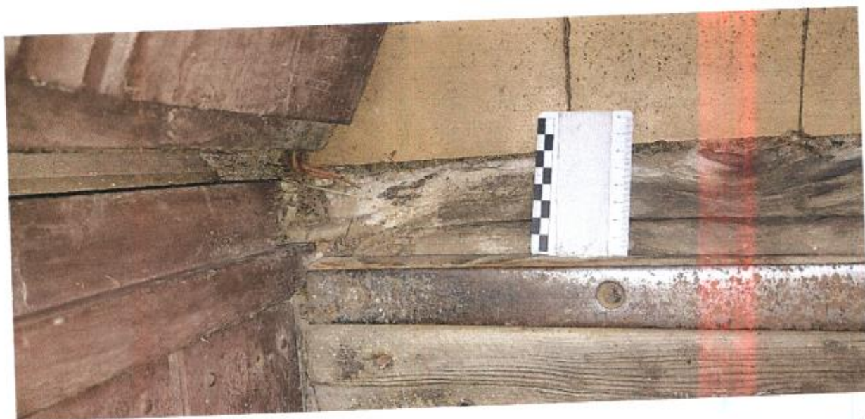
Fot.8 Kościół pw. Przemienienia Pańskiego, Sońsk, drzwi główne, osłabiony próg w części prawej od wejścia, fot. R Gazda, 2024
