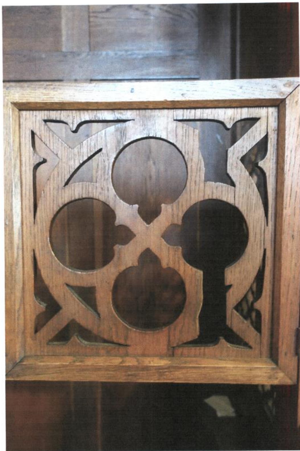
Fot. 5. Kościół pw. Przemienienia Pańskiego, Sońsk, konfesjonał, nawa, ściana lewa, ubytki formy snycerskiej ażurowej zasłony, fot. A. Bogusz - Gazda
