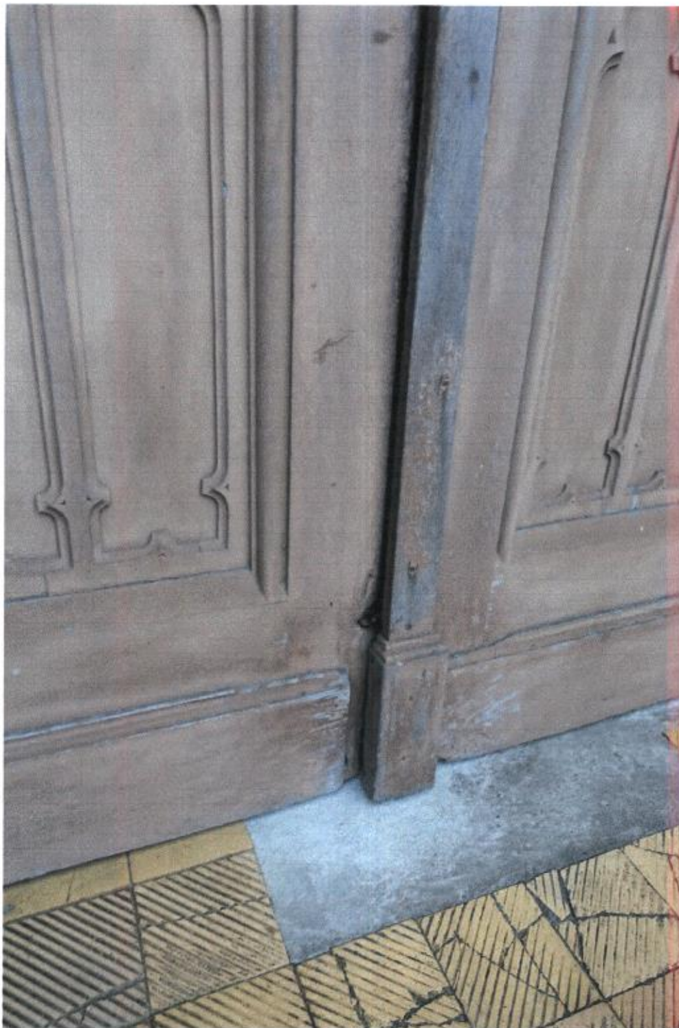
Fot.4. Kościół pw. Przemienienia Pańskiego, Sońsk, drzwi główne, od zewnątrz, zniszczenia powierzchni, fot. A. Bogusz – Gazda, Budynek kościoła pw. Przemienienia Pańskiego wpisany do rejestru zabytków pod nr. A-810
