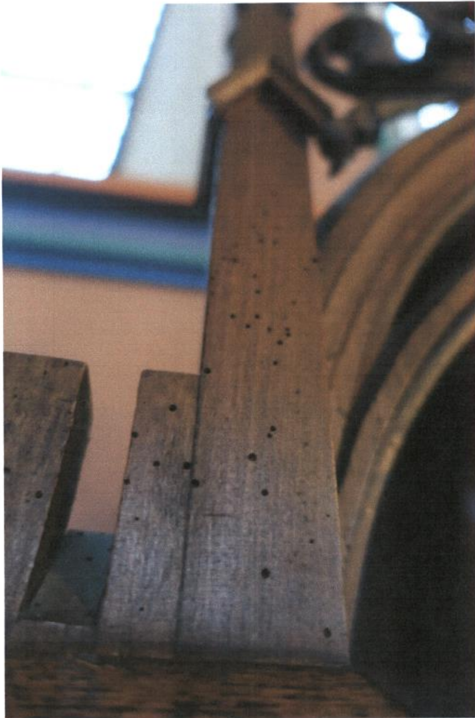
Fot. 7. Kościół pw. Przemienienia Pańskiego, Sońsk, konfesjonał, nawa, ściana lewa widoczne ślady żerowania drewnojadów, fot. A. Bogusz - Gazda
