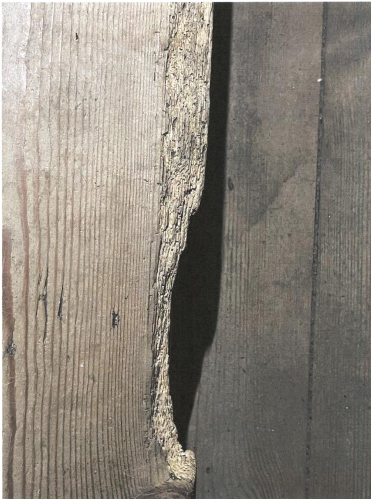
Fot.9. Kościół pw. Przemienienia Pańskiego, Sońsk, prospekt organowy, odwrocie szafy organowej, widoczne zniszczenie struktury drewna i ślady zerowania szkodników, fot. R. Gazda
