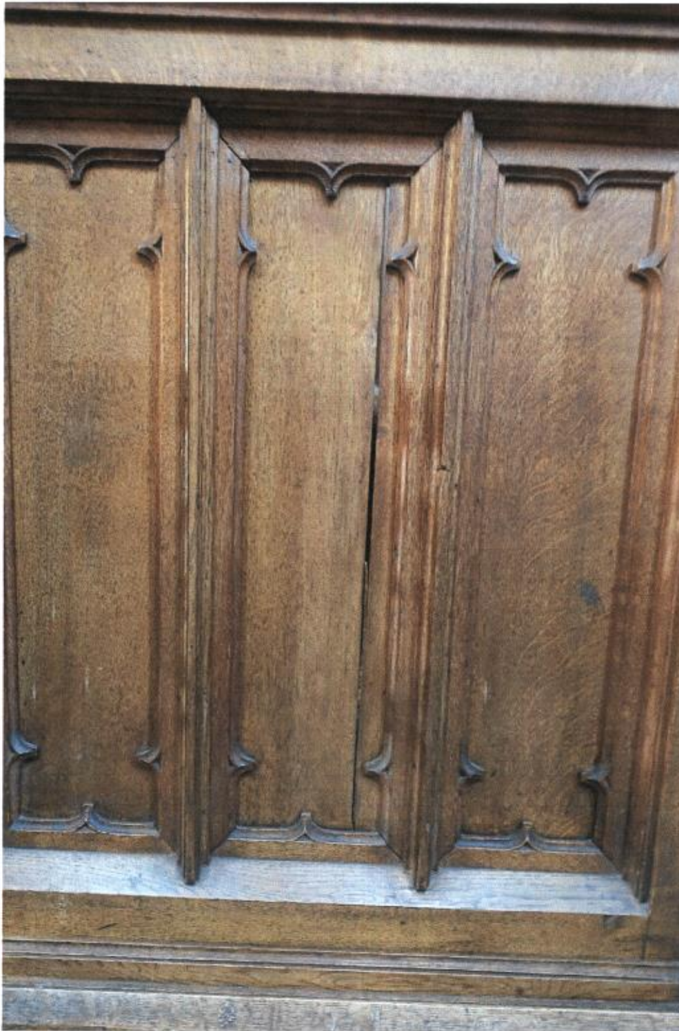
Fot.13. Kościół pw. Przemienienia Pańskiego, Sońsk, konfesjonał jednostronny, prezbiterium, po lewej stronie ołtarza, pęknięcie z ubytkiem w płycinie na ścianie licowej, fot. A. Bogusz - Gazda
