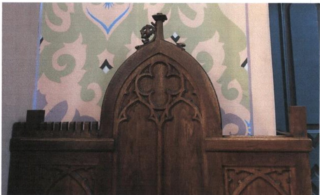
Fot.20,21. Kościół pw. Przemienienia Pańskiego, Sońsk, Ławka kolatorska, prezbiterium, lewa strona ołtarza po prawej stronie (20) i lewej (21) drzwi do Zakrystii, ubytek pasa ornamentalnego kostkowego, elementów snycerki w zwieńczeniu, fot. A. Bogusz - Gazda
