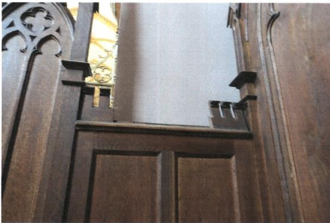
Fot.11,12. Kościół pw. Przemienienia Pańskiego, Sońsk, konfesjonął jednostronny, prezbiterium, po lewej stronie ołtarza, widoczne ubytki formy snyczerki w zwieńczeniu, pinaklach, i ornamencie kostkowym, fot. A. Bogusz - Gazda
