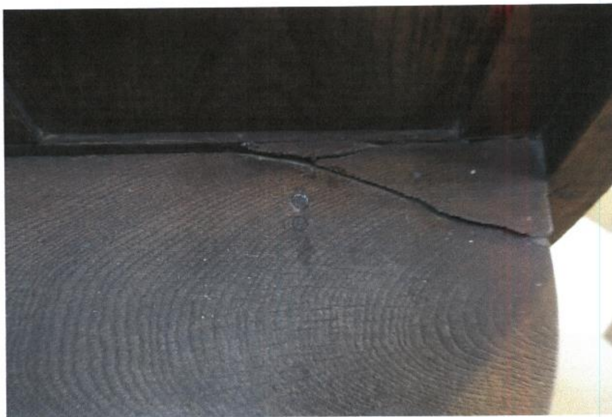
Fot. 9. Kościół pw. Przemienienia Pańskiego, Sońsk, konfesjonał, nawa, ściana prawa widoczne pęknięcie formy kłęcznika, fot. A. Bogusz - Gazda
