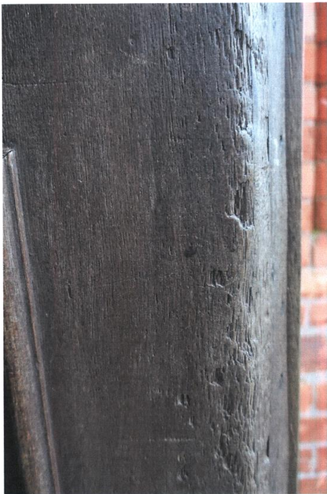
Fot.6. Kościół pw. Przemienienia Pańskiego, Sońsk, drzwi główne, od zewnątrz, zniszczenia powierzchni, fot. A. Bogusz – Gazda, 2024
