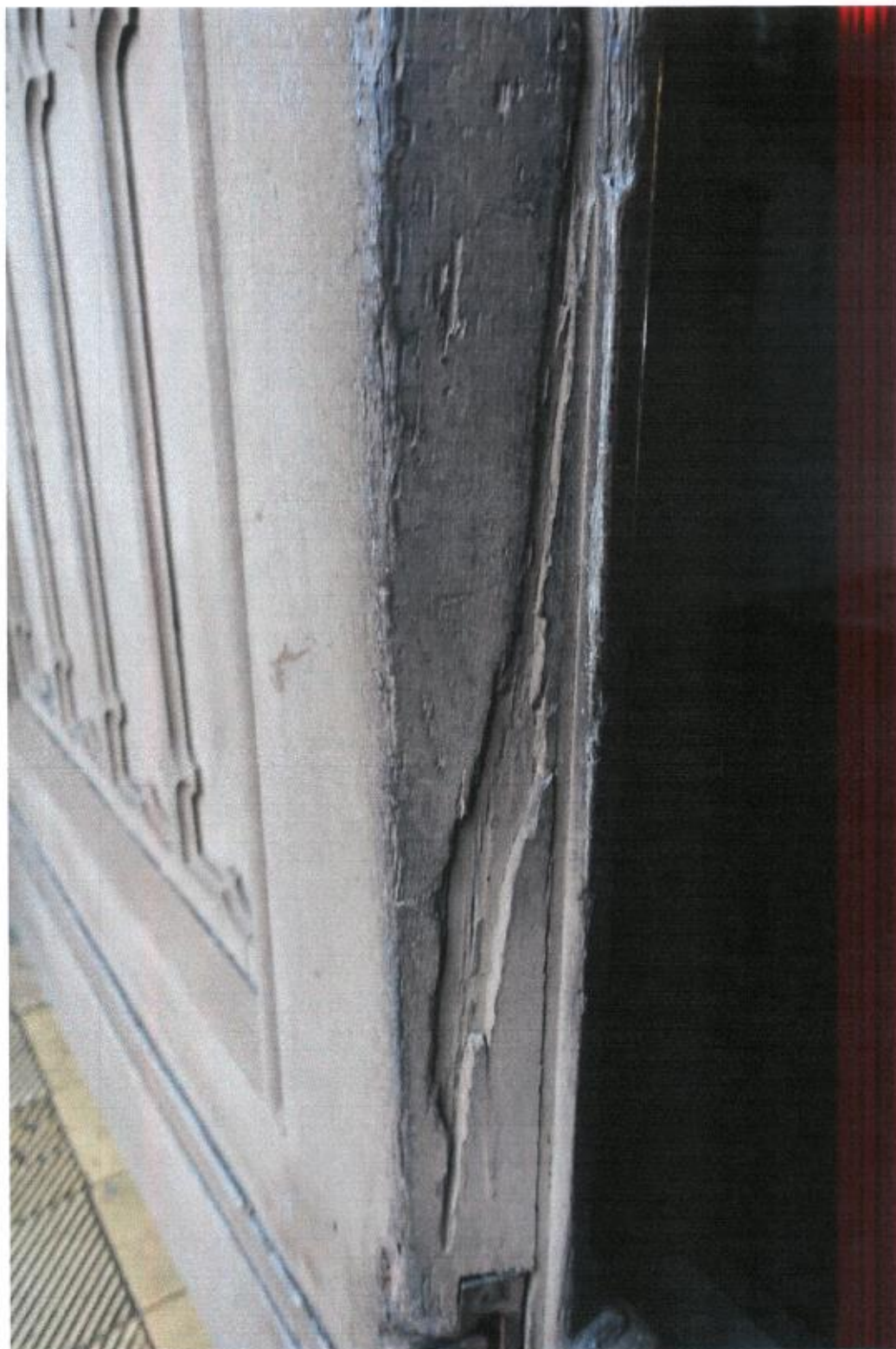
Fot.7. Kościół pw. Przemienienia Pańskiego, Sońsk, drzwi główne, od zewnątrz, zniszczenia powierzchni, fot. A. Bogusz – Gazda, 2024
