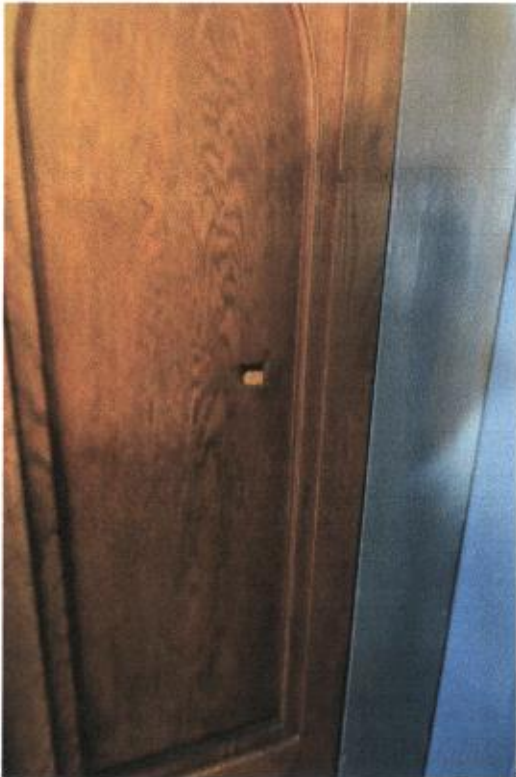
Fot.15,16. Kościół pw. Przemienienia Pańskiego, Sońsk, Ławka kolatorska, prezbiterium, prawa strona ołtarza po lewej stronie drzwi do Kaplicy, ubytek pasa ornamentu kostkowego i dziura w płycinie bocznej, fot. A. Bogusz - Gazda
