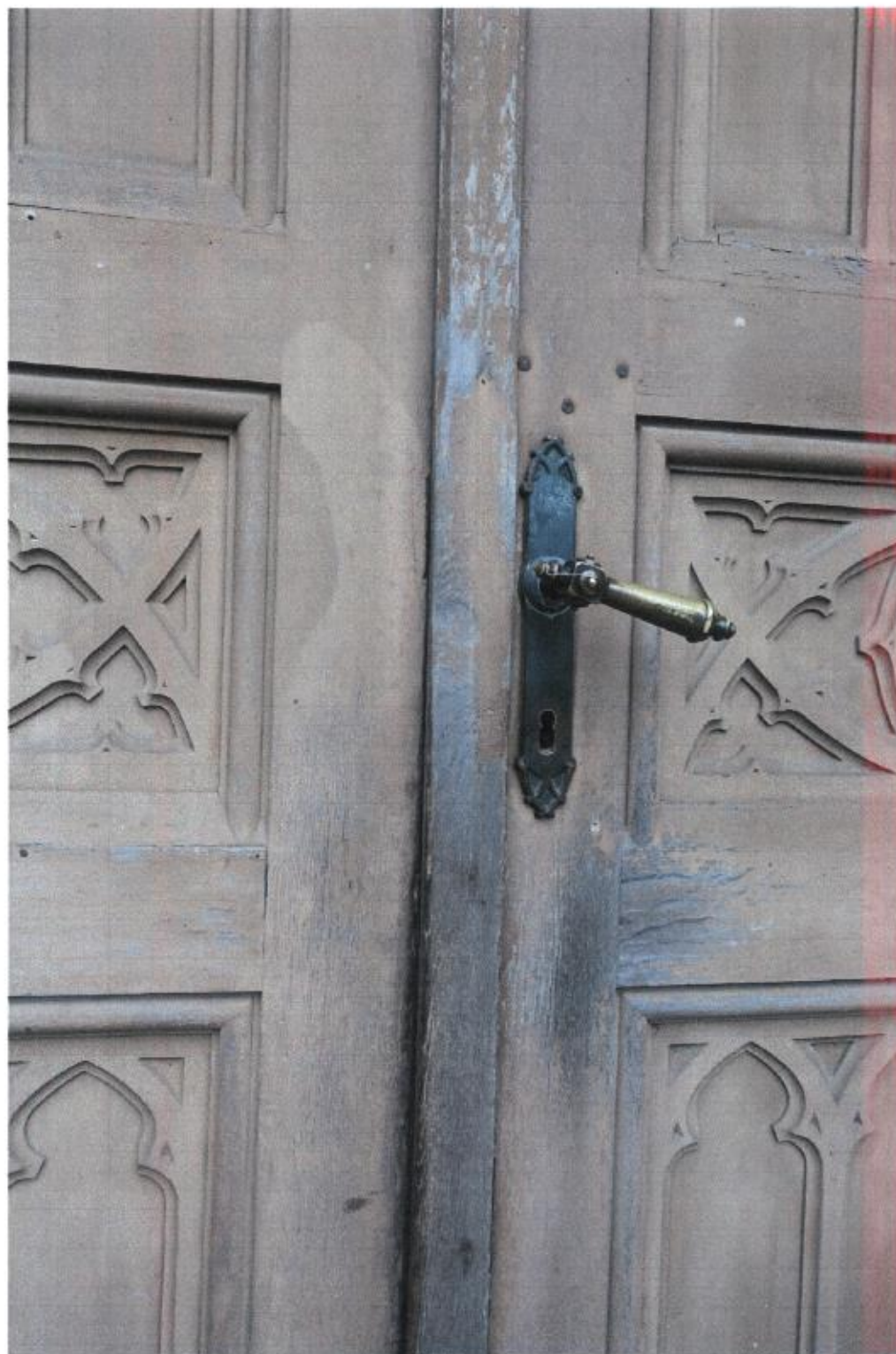
Fot.3. Kościół pw. Przemienienia Pańskiego, Sońsk, drzwi główne, od zewnątrz, zniszczenia powierzchni, fot. A. Bogusz – Gazda'2024
