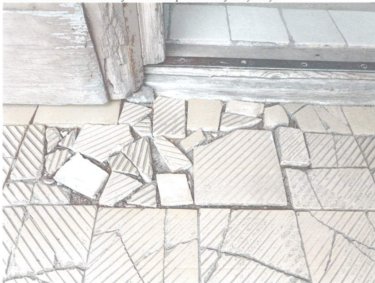
Fot. 3. Uszkodzenia zniszczonej nawierzchni przeznaczonej do wymiany.
