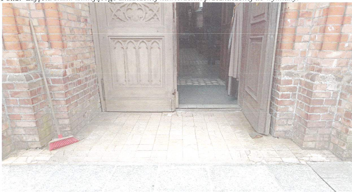
Fot.2. Zdjęcia stanu istniejącego zniszczonej nawierzchni przeznaczonej do wymiany.
